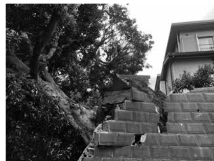
図78 大木が傾き石垣の一部も崩れる
